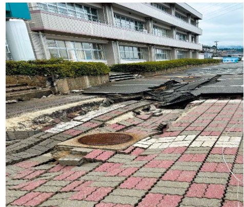
七尾市 中学校校舎前の被災状況
