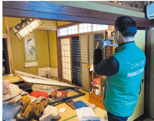
被害箇所の確認
