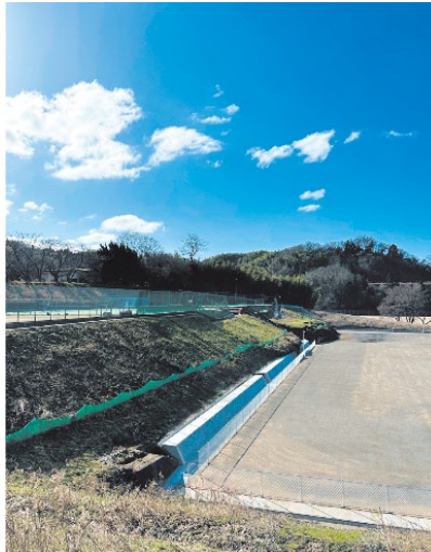
グラウンド内に土砂崩れ
